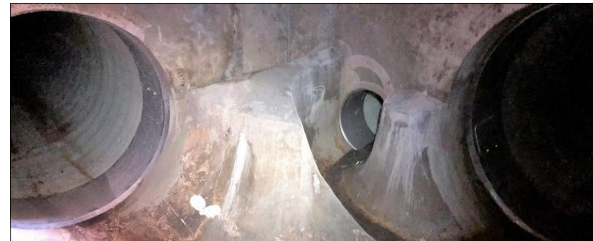
So sieht der sanierte Regenwasser-Kanal unter dem Flugfeld der Kaserne in Katterbach jetzt aus.
